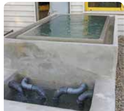
Dans le petit bassin-test, l'eau de la goulotte est évacuée par 4 écoulements gravitaires qui se jettent dans un bac tampon
